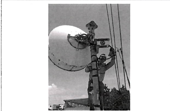
Chequeo de cableado en la microonda
