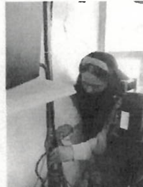
Limpeza y revisión de conexiones
