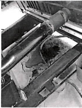
Se detecta fuga de líquido en parte de anticongelante y bomba de agua.
