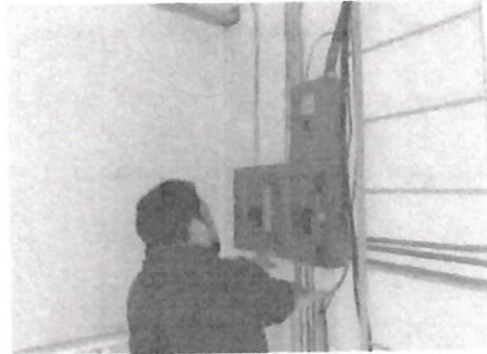
Revisión de sistema eléctrico
