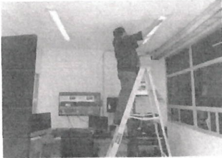
Limpieza de lámparas
