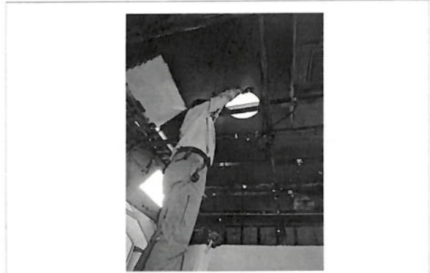
Limpieza de eliminación tipo "Cazuela"
